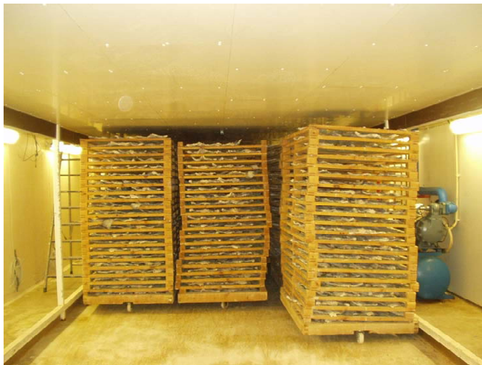
Figur 13. Tverrblåst batch tørketunnel fra Frigosistema.
